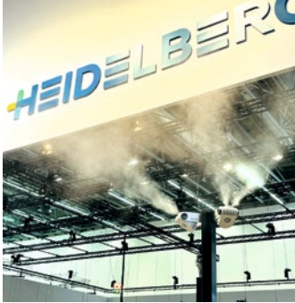
Das Condair System TurboFog Neo bei Heidelberg in der Halle 1.
